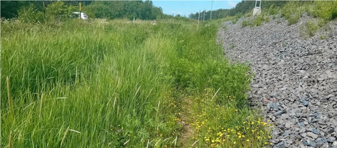
Kuva 11 Kappelinsalmen heinäkasvien peittämä radanvieri.
